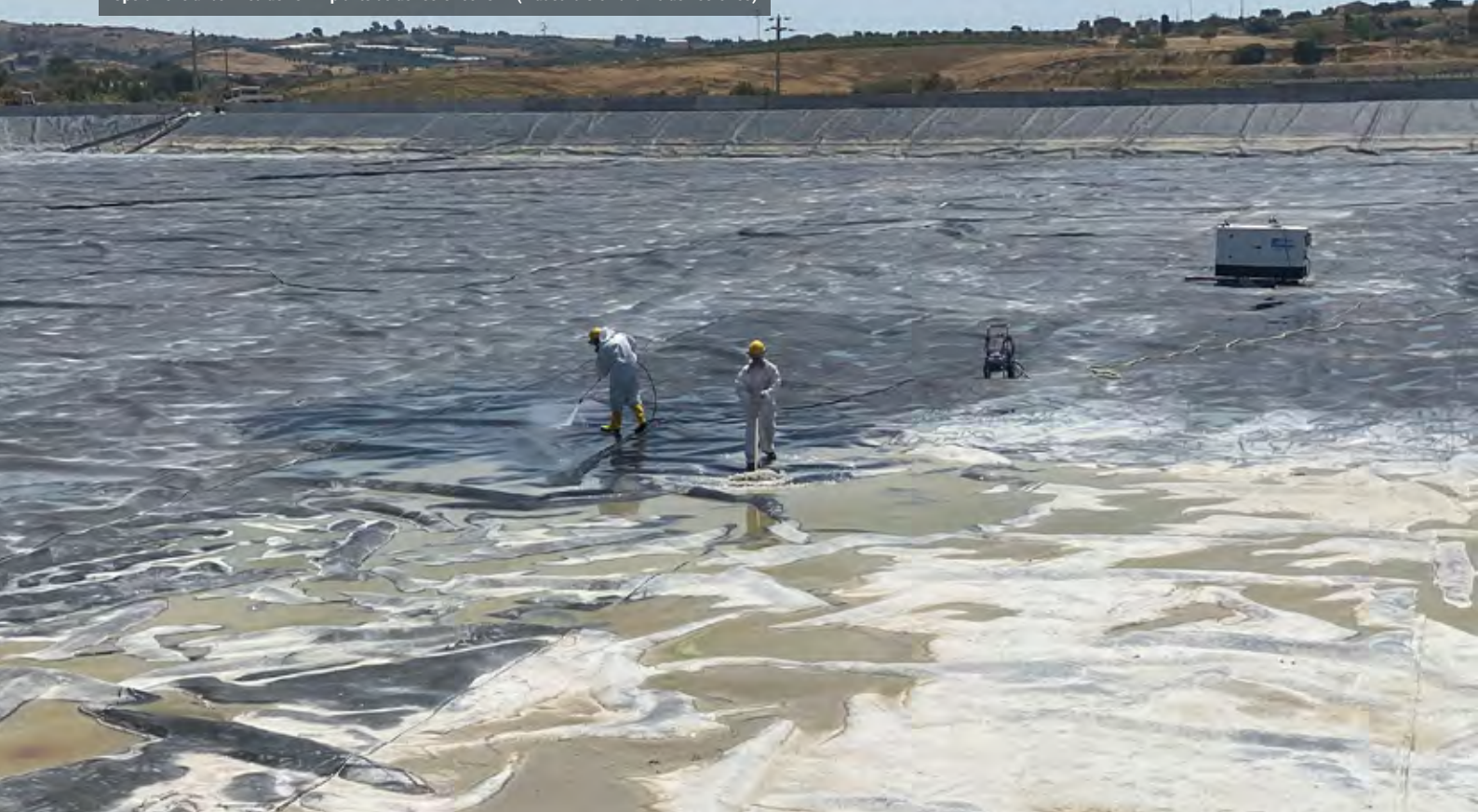
Operazione di bonifica dell'ex impianto acido fosforico ISAF (Industria Siciliana Acido Fosforico)
