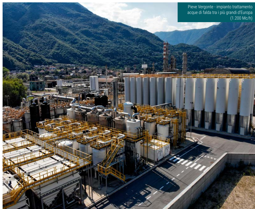
Impianto di osmosi inversa
